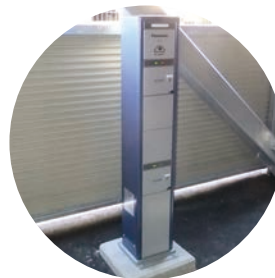
EV・PHV充電設備
