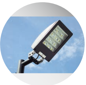
ポール付LED照明設備
