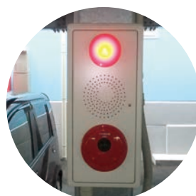
自動火災報知設備
