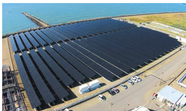
太陽光発電設備
