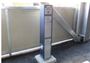
● EV・PHV充電設備
